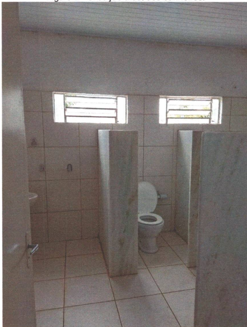
Figura 2 - Situação atual dos banheiros.
