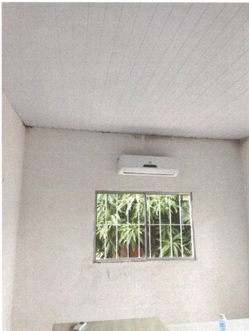
Figura 3 - Situação atual de pintura e esquadria.
