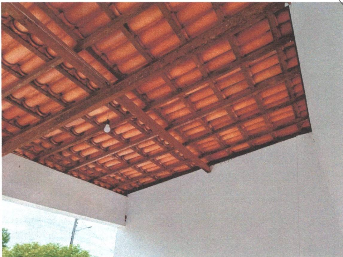
Figura 4 - Situação atual de telhas e madeiramento.
