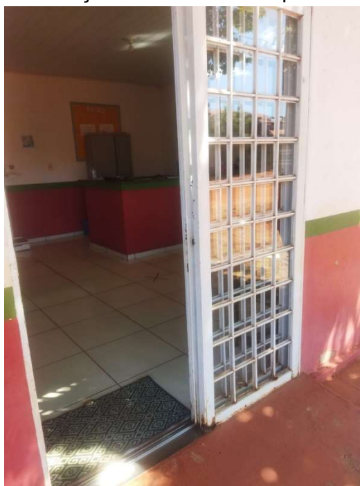
Figura 4 - Situação atual da UBS do povoado Salto.
