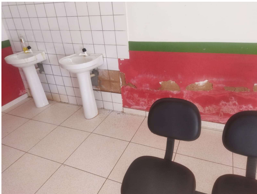
Figura 1 - Situação atual das paredes internas da UBS do Oziel pereira.
