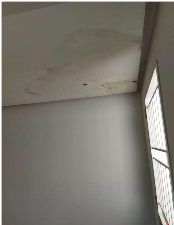
Figura 3 - Situação atual da cobertura da UBS da Nova Veneza.
