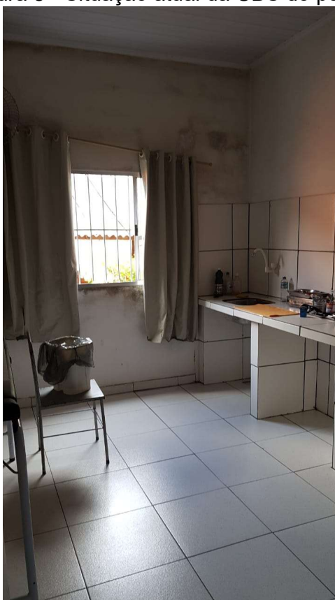
Figura 8 - Situação atual da UBS do povoado Patis
