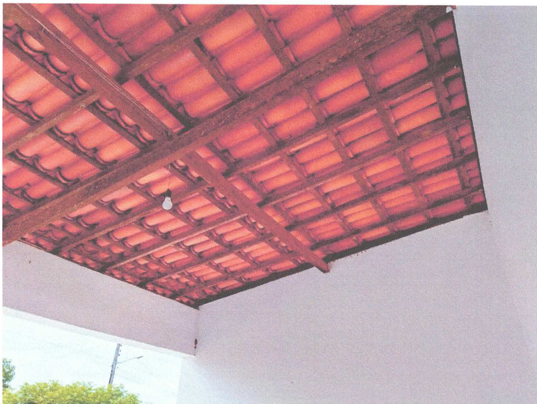
Figura 4 - Situação atual de telhas e madeiramento.
