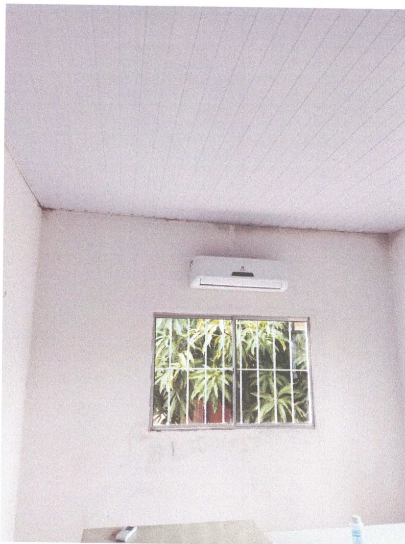
Figura 3 - Situação atual de pintura e esquadria.
